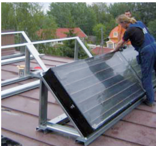
Bild 4 och 5: Lyft solfångaren på plats med hjälp av lyftkran. Med stor precision kan de flesta kranförare sätta solfångaren rätt på millimetern.
